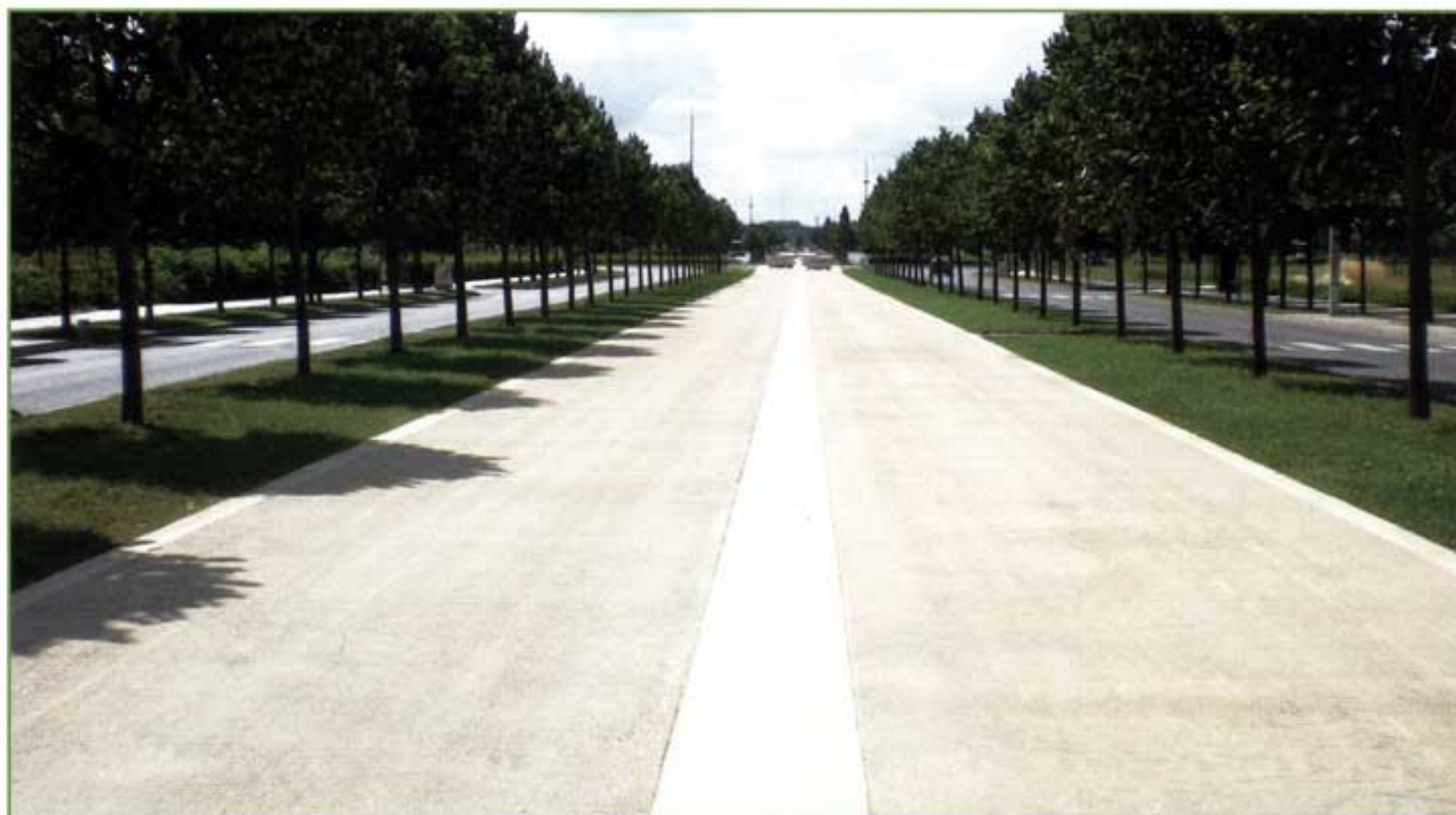
La voie du TZen hydrodécapée avec ses bordures et son caniveau central non traités.
