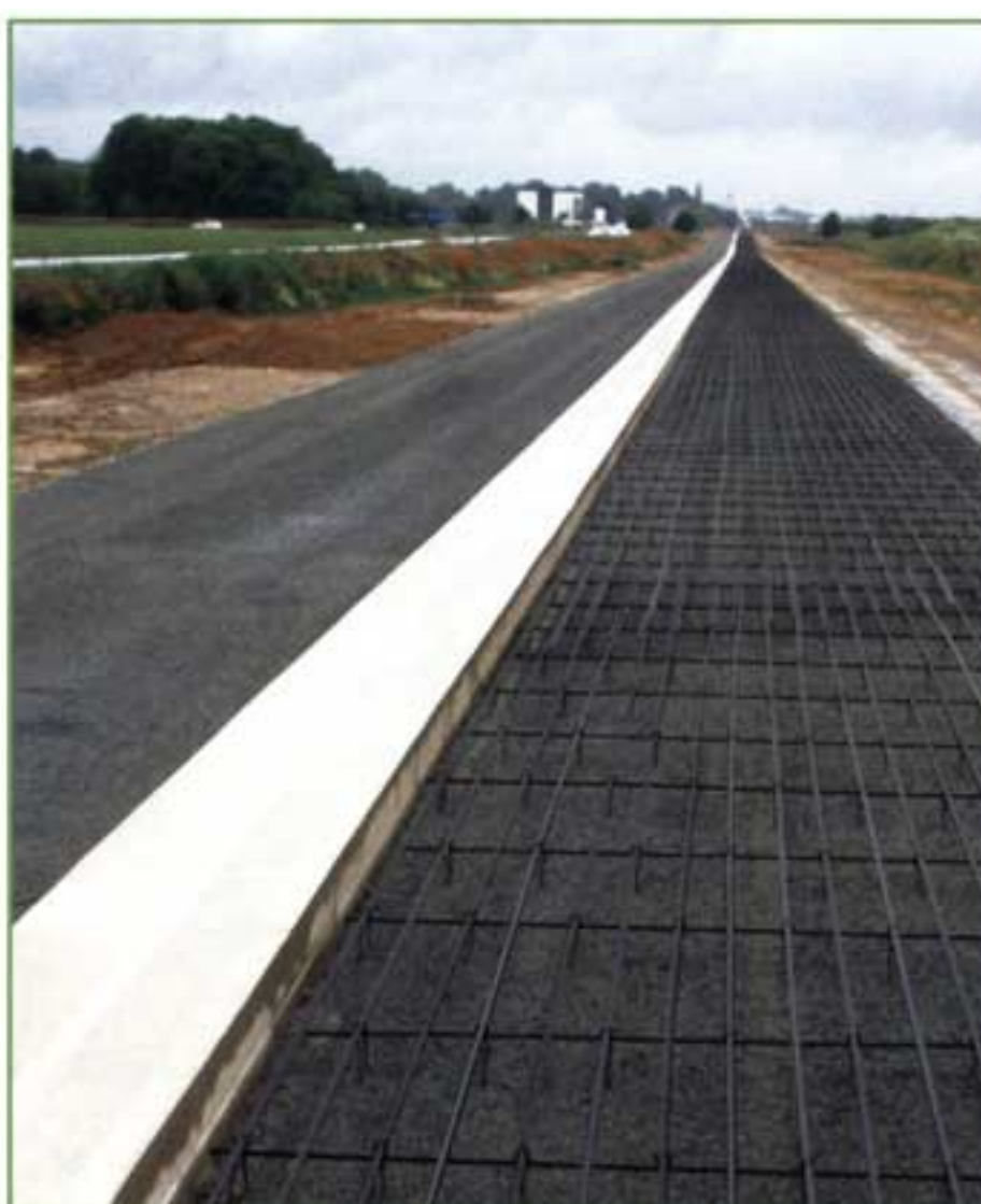
Après la réalisation de la couche de fondation en béton maigre de 15 cm et du caniveau central, les armatures métalliques sont posées pour recevoir le coulage du béton armé continu (BAC).
