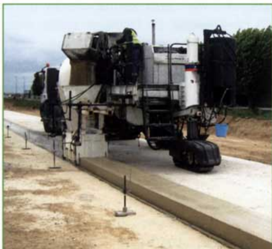
Avant la mise en œuvre de la couche de roulement, coulage du caniveau central en béton extrudé.
